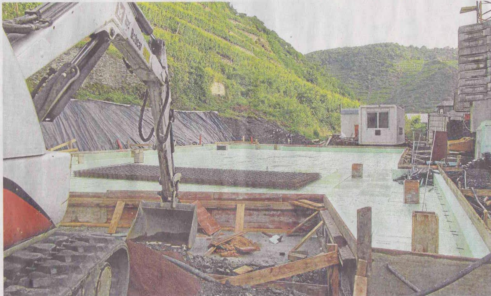
Unmittelbar hinter der Kirche entsteht in Kobern-Gondorf das Pfarrzentrum. Die Umriss des Gebäudes kann man schon erkennen.
