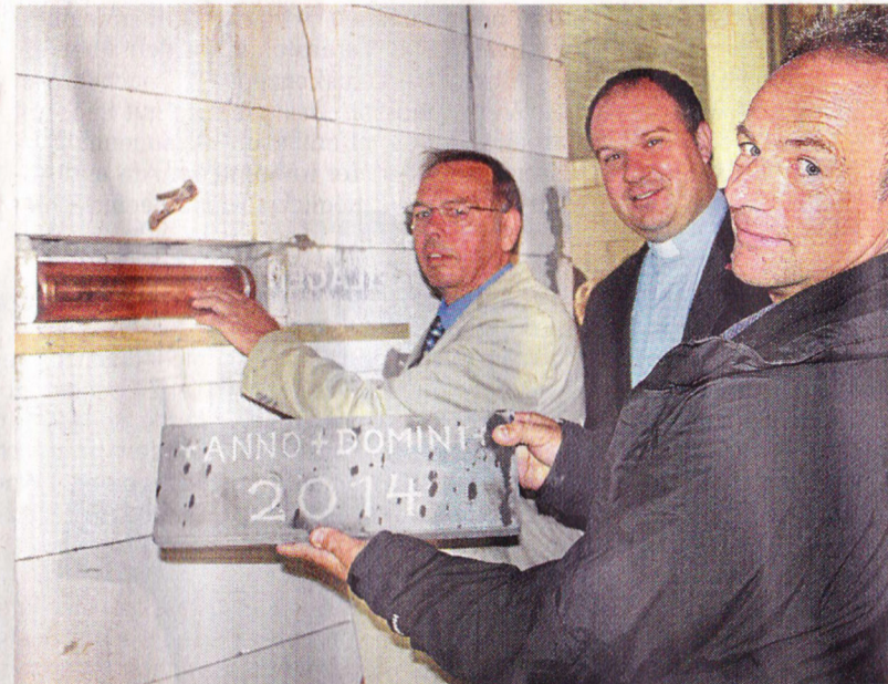
Der stellvertretende Pfarrverwaltungsrats-Vorsitzende Leo Freudenberg (von links), Pastor Jörg Schuh und Baupolier Harald Helm hinterlegten in eine Maueröffnung eine Zeitkapsel mit Urkunde.
